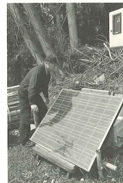
井戸ポンプ用ソーラーパネル
